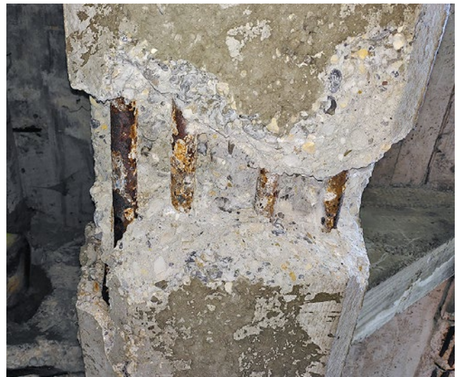
Gecorrodeerde Interne wapening
